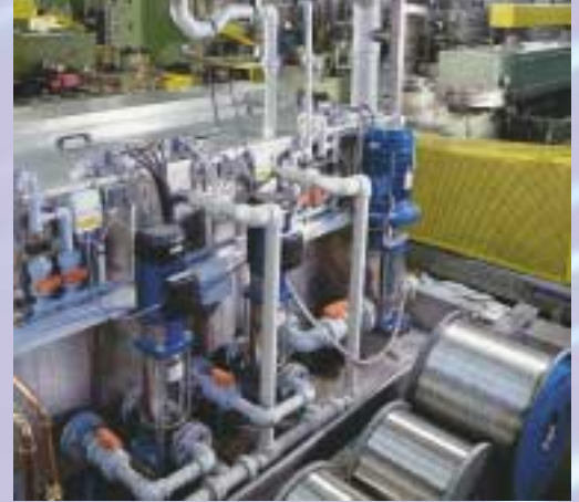
Durchlauf Reinigungs- und Entfettungsanlage. Continuous cleaning and degreasing line.
